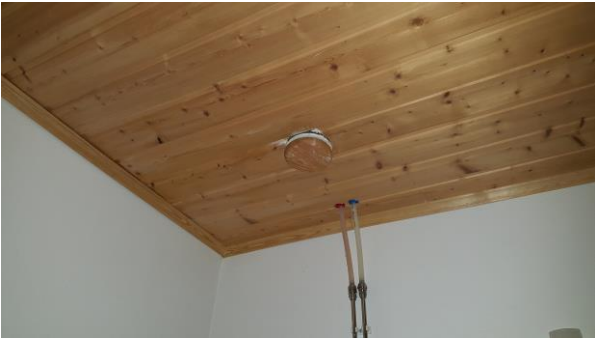
25. Wc -tilan poistoilmaventili.
