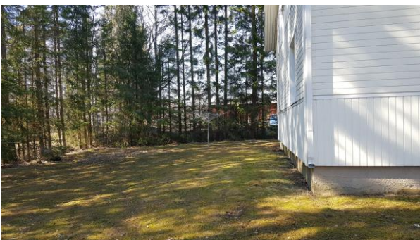
5. Pihan kallistukset ovat hyvät. Vajautta kuitenkin etujulkisivulla ja osin päädyissä.
