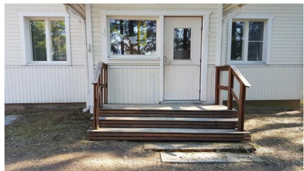
6. Kulunut ulko-ovi tulisi vaihtaa uuteen.
