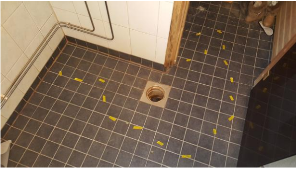
17. Pesuhuoneen ja osittain saunankin lattia kosteus oli kohollaan ja seinien alaosat suihkun vaikutusalueella. Rakenteessa ei ole vesieristystä.
