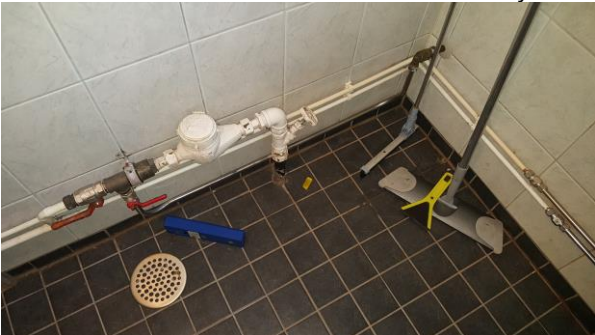
19. Pesuhuoneeseen on sijoitettu myös vesimittari.
