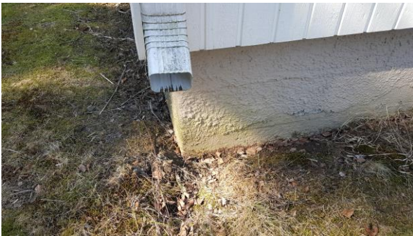
1. Rakennuksen ympäriltä puuttuu loiskekaivot ja maanalainen sadevesijärjestelmä.
