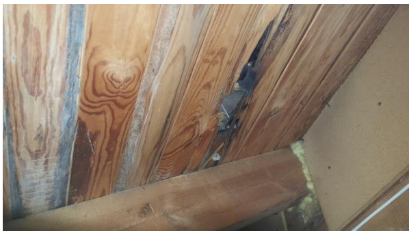
15. Huopakatteessa on ollut vaurioita. Levyt kattotuolin väleistä tulisi purkaa sivunkaisessa.
