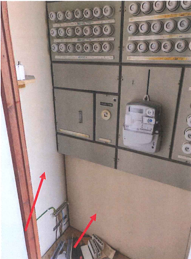
Kuva 2. Sähkötaulun kotelolevyt asbestia sisältävää lujalevyä.
